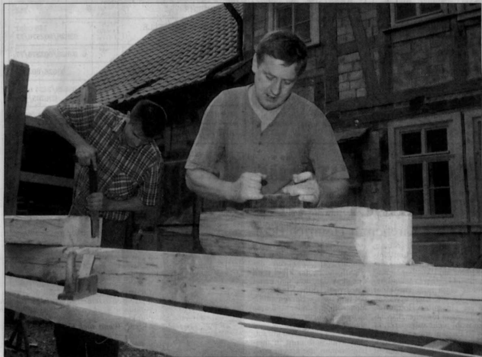
IN HANDARBEIT: Selbst zum Hobel greift Norbert Dagg, um die alten Balken des ehemaligen Malzwerkes zu bearbeiten. Fachmännisch wird er dabei von Zimmerer Olaf Greßler unterstützt. TA-Fotos: HP STADERMANN
